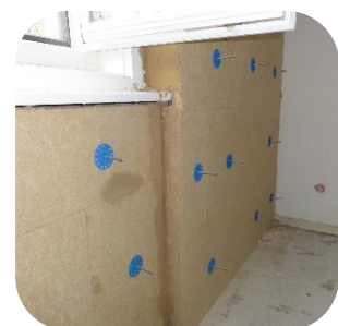
Beispielhafte Innendämmung, die bereits in einer der Wohnungen Ihrer WEG durchgeführt wurde. Foto: ifeu, 2023
